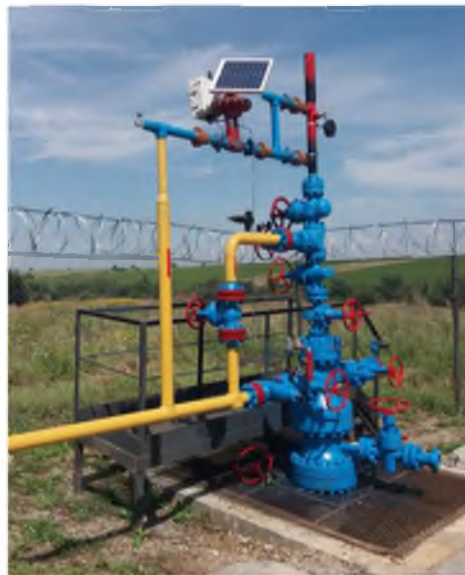
Рисунок 3.7 – Експлуатація свердловини із встановленим обладнанням для очистки внутрішньої поверхні НКТ
