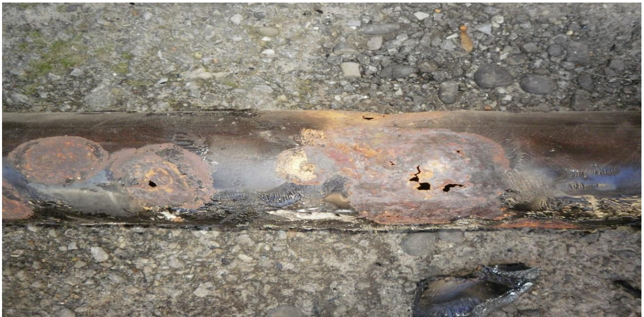
Рисунок 1.5 - Отвори газопроводу, утворені вибоком газу в с.Н.Липиця по вул.Центральна
