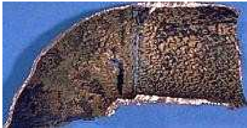
Рисунок 1.9 – Ерозійно-корозійне пошкодження у вигляді підкови в мідному трубопроводі.
