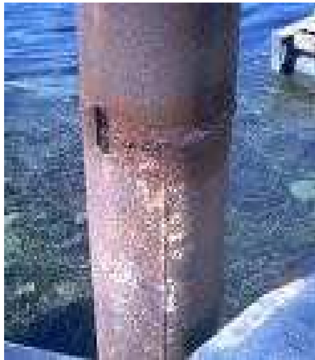
Рисунок 1.10 – Загальна корозія конструкційної сталі
